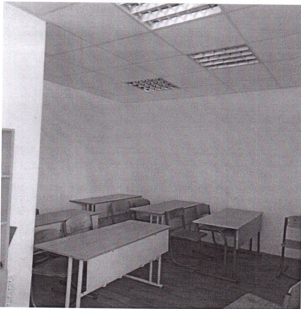
5-6: Загальний вигляд об'єкта оцінки: стан стелі, дверей, підлоги, стін та протехнічного обладнання.
